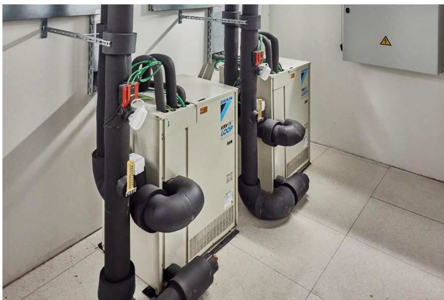
Die großen Büroetagen werden mit wassergekühlten VRV Systemen von Daikin versorgt, die jeweils eine Kühlleistung von 60 kW liefern. © Daikin
