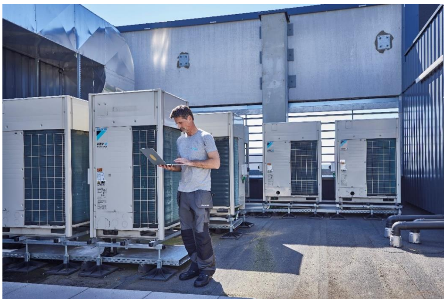
Im Bürogebäude des EDC sorgen neun luftgekühlte VRV 5 Systeme mit Wärmerückgewinnung sowie vier weitere luftgekühlte VRV 5 Systeme, die mit den Lüftungsgeräten verbunden sind, für optimale Raumklimabedingungen. © Daikin
